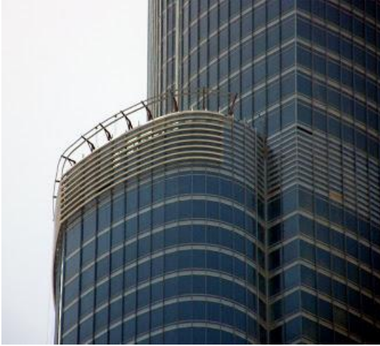
الصورة (82): لقطة توضح إكساء الواجهة الزجاجي بمساحة كبيرة ضمن مناخ دبي الحار جداً
